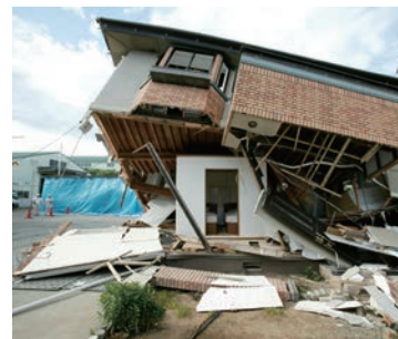
耐震シェルターが設置された木造住宅が地震により倒壊した場合
