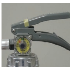
× 安全栓の脱落
