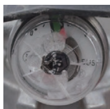
× 指示圧力計の損傷
