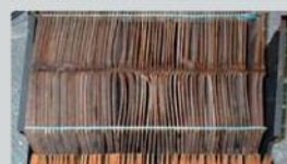
加湿エレメントの老朽化
